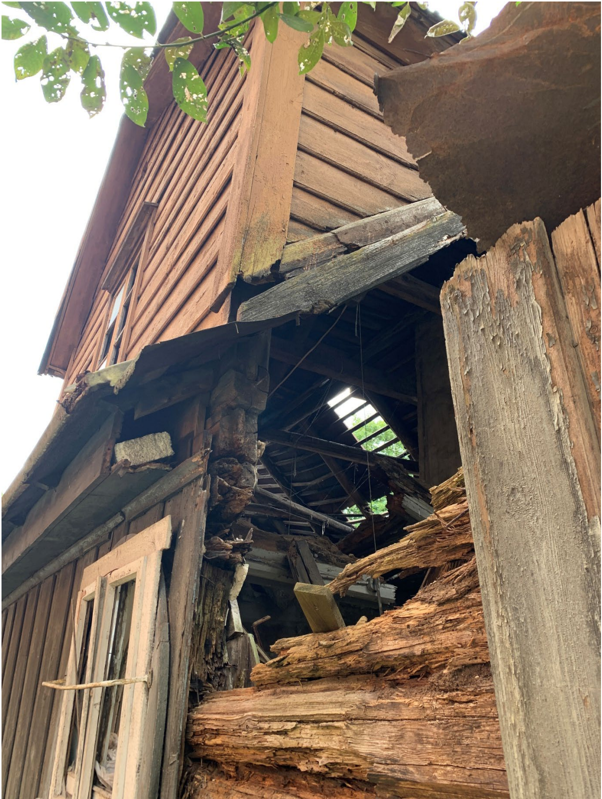
Foto 5. Uus tn 16//18 vanalagunenud elamu Uus tn 14 kinnistult vaadatuna. Endise elamu palksein on mädanenud ning pehkinud. Katus on mõnedes kohtades sisse vajunud ning samamoodi vahelagi on sisse kukkunud.
