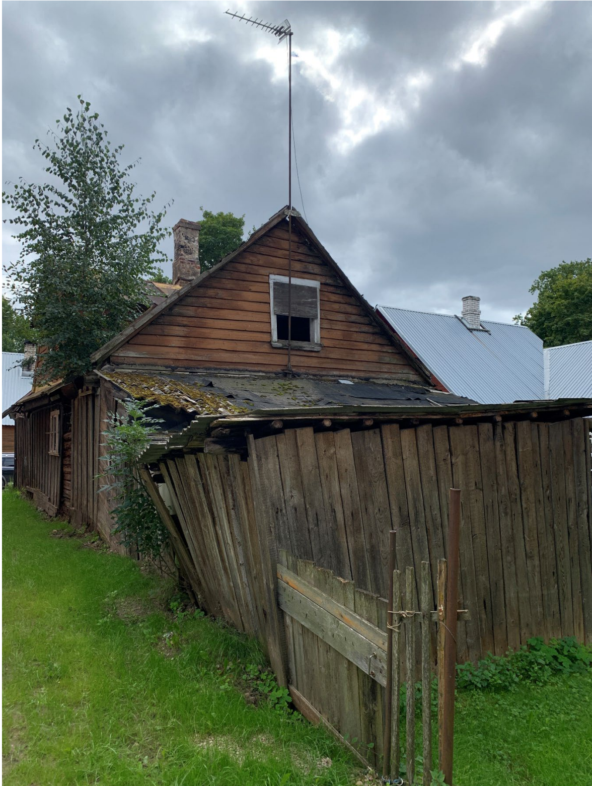
Foto 6. Uus tn 16//18 vana elamu ja elamu küljes asuv kuur Uus tn 14 kinnistu hoovipoolt vaadatuna. Endise elamu katusel kasvavad puud. Lagunenud elamu kõrval asub poolenisti kokku kukkunud kuur. Kuuri katus on mädanenud ja kokku varisenud, kuuri seinad on viltu ning laiali vajunud. Kuuri seintest kasvavad läbi suuremad taimed.
